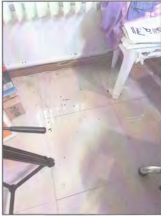
ภาพบางส่วนแสดงน้ำรั่วซึมจากผนังเข้าสู่อาคาร
