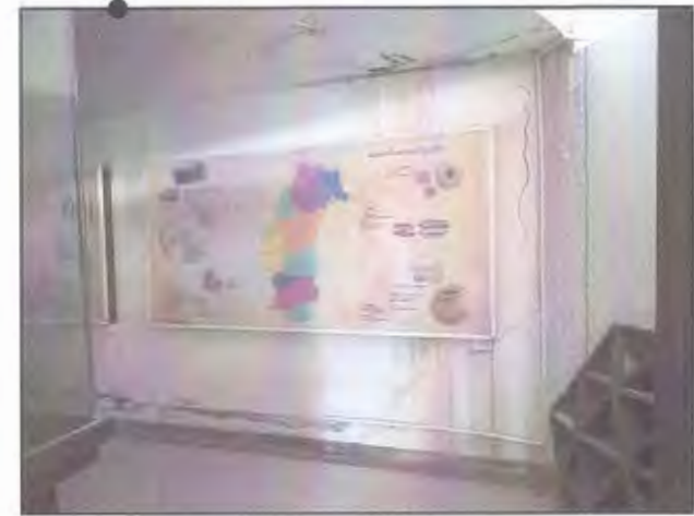
ภาพบางส่วนแสดงน้ำรั่วซึมจากผนังเข้าสู่อาคาร
